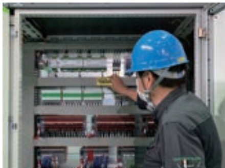
制御盤内部 両面テープで取付け
